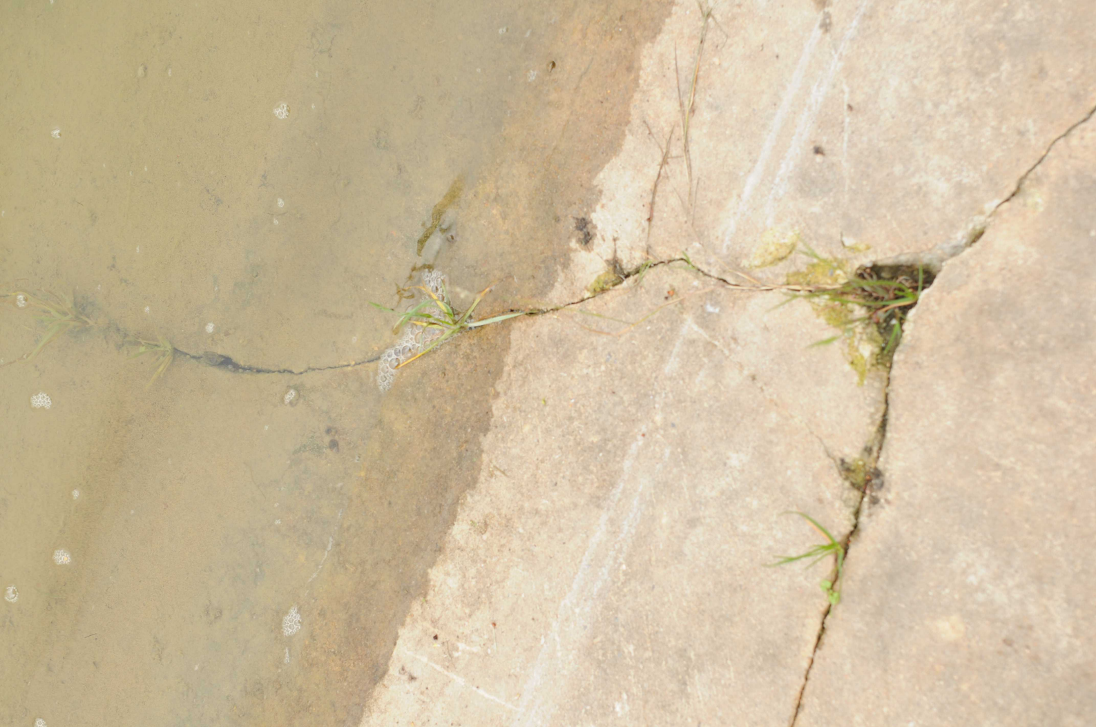
16. Risse im Beton
